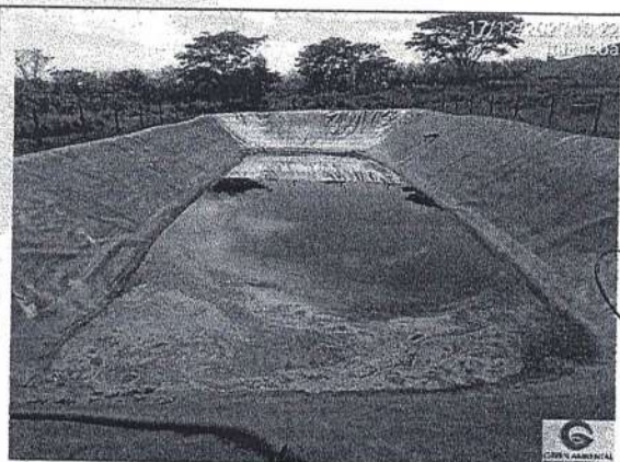
Lagoa com nível extremamente baixo. — Aterro Sanitário de Ituiutaba.
