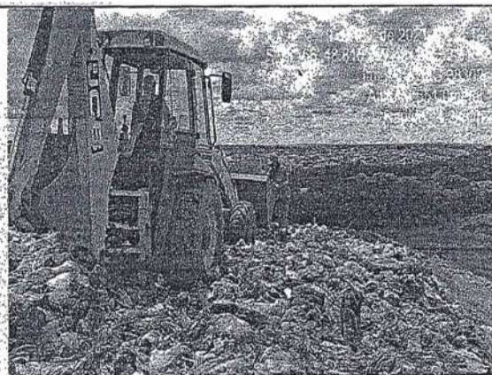
Montagem do Biogás. — Aterro Sanitário de Ituiutaba.
