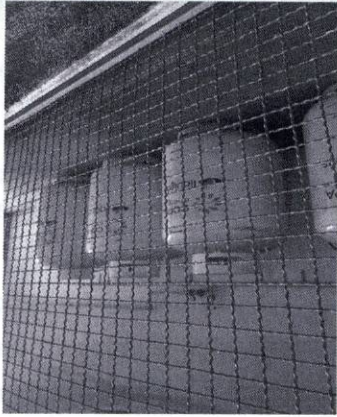
ARMAZENADMENTO DE GAS NA ÁREA EXTERNA
