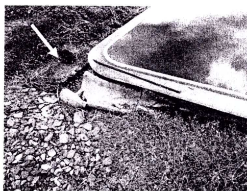
Foto 26: canaletas quebradas no entrono da piscina
